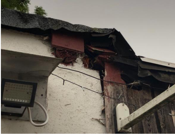
Abb.8: Spalten an Dach
