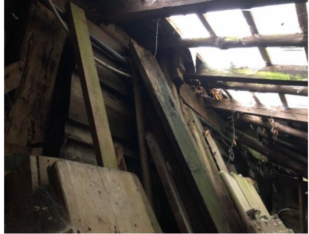
Abb.9: Teilweise eingestürzte Innenräume
